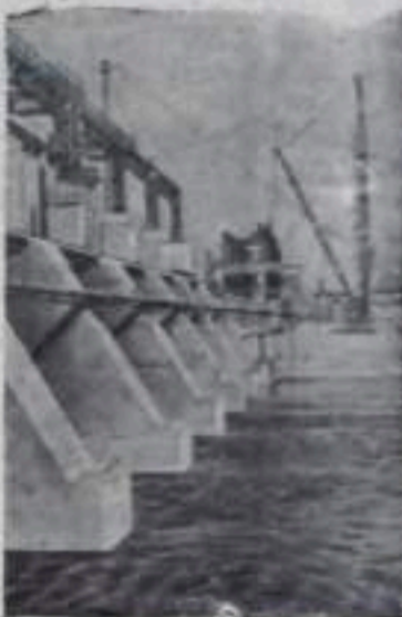
Молдавская ССР. Дубоссарская ГЭС, строительство которой близится к концу — первая ступень будущего каскада гидроэлектростанций на Днестре. Новая станция будет питать током заводы и фабрики Кишинева, Тирасполя, Оргеева, машинно-тракторные станции и колхозы ряда районов республики.
