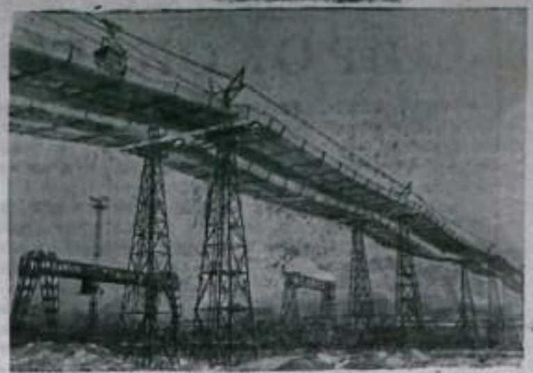
Куйбышевгидрострой. По канатной подвесной дороге от ламбедробильного завода на горе Могутовой до бетонного завода по четырем стальным канатам движется более 70 вагонов, которые перевозят 180 тонн щебня в час.
