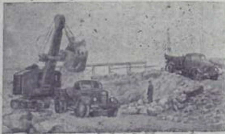
Казань. С наступлением теплых весенних дней развернулись работы на строительстве Казанского речного порта. В этом году коллектив строителей закончит разработку акватории (водной части порта) и сооружение металлической причальной стенки.
