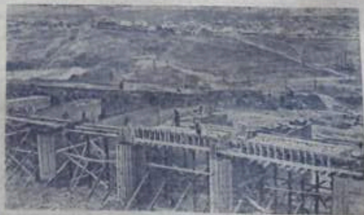
В Крыму, в районе Симферополя, сооружается водохранилище, которое даст воду полям многих колхозов и совхозов. После заполнения водохранилища водами реки Салгира образуется проточный озеро глубиной 35 метров, шириной 1—1,5 километра и длиной 7 километров.
