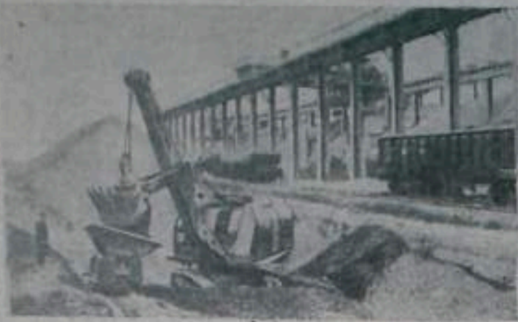
СТАЛИНСКАЯ ОБЛАСТЬ. Трудящиеся Енакиевского цементного завода решили дать стройкам Донбасса до конца года 5.500 тонн сверхпланового цемента. Свои обязательства они успешно выполняют. Все работы на сырьевом складе завода полностью механизированы. НА СНИМКЕ: на сырьевом складе цементного завода. Фото С. Гендельмана.
