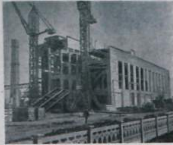
Новая Симферопольская выдана областно-подразделением строительства ГРЭС. Строительство электростанции ведется на объекте, выделенном в Крыму. В этом году будет начато строительство первой очереди. Сейчас идет монтаж турбины и генератора, отладка распределительного устройства и главного щита управления. Второй очереди. На снимке: строительство главного корпуса ГРЭС. Фото Г. Бордана. Фотография ТАСС.
