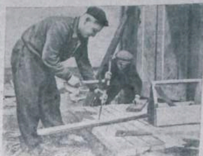
КЕМЕРОВСКАЯ ОБЛАСТЬ. Недалеко от города Сталинска началась подготовка к строительству Западно-Сибирского металлургического завода. Новый гигант металлургии будет иметь домны объемом 2,286 кубометров. Площадь пода каждой мартеновской печи будет равна 500 квадратным метрам.
