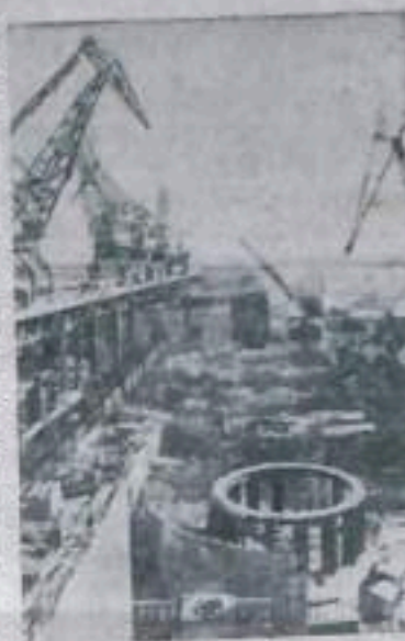
коллективом строителей Иркутской ГЭС за досрочное выполнение годовой программы и своевременныйпуск основных сооружений гидроузла. НА СНИМКЕ: в котловане здания ГЭС на левом берегу Оби.
