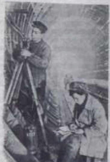
Москва. Строительство 5-й очереди метрополитена имени В. И. Ленина. НА СНИМКЕ: маркшейдер В. Кабанов и А. Кохтенко за нивелировкой подольского тоннеля к станции «Всесоюзная сельскохозяйственная выставка».
