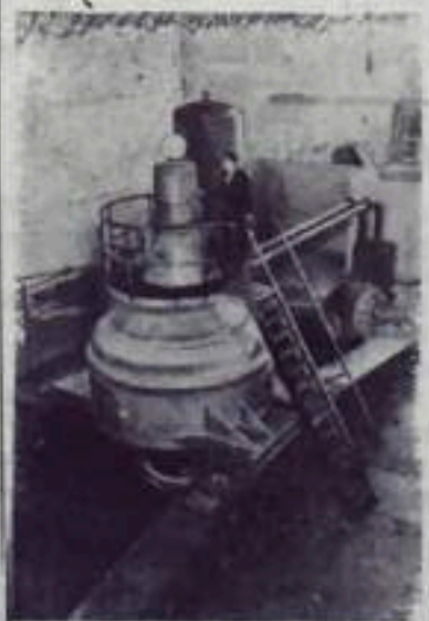
Эстонская ССР. Нарвская ГЭС вступила в строй. Ее первый гидроагрегат дал промышленный ток. НА СНИМКЕ: в машинном зале станции.
