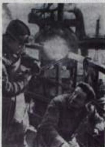
Строительство мощной доменной печи на металлургическом заводе в городе Озде. Фото Интерфото МТИ-ТАСС.
