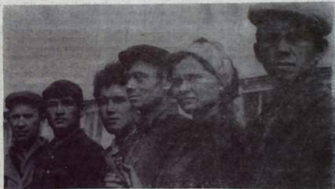
Бригада коммуниста И. А. Куприянова ведет санитарно-технические работы в новой школе. Сплоченный коллектив из месяца в месяц выполняет задания на 115—120 проц. при хорошем качестве. НА СНИМКЕ: комплексная бригада ПМК треста «Башсантахмонтаж».
