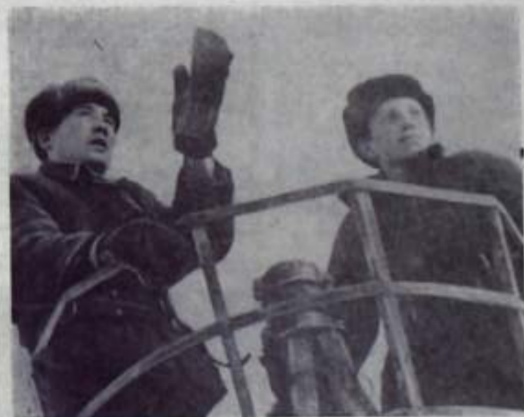
Слаженно работают в Кумертауских южных межрайонных электрических сетях электромонтеры З. Гизатуллин и его ученик Ю. Анисим, которые запечатлены на этом снимке. Они исполняют верховые работы по монтажу и ремонту линий электропередачи. Это ответственное дело требует смелости, знаний, твердых практических навыков. Молодые специалисты хорошо овладели своей профессией, с поставленными задачами справляются четко и оперативно. Основной задачей в новом году они считают дальнейшее улучшение электроснабжения, повышение качества и производительности труда. Фото Ю. ЛАРИНА.
