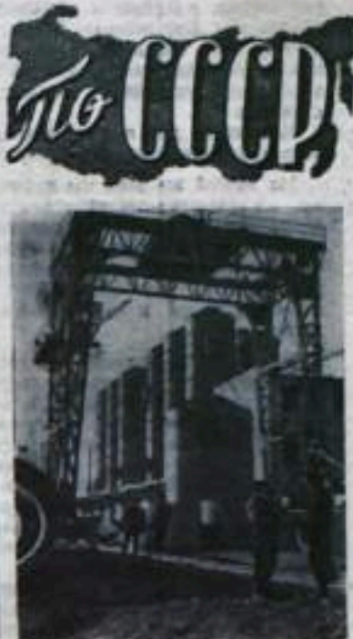
Азербайджанская ССР. В Кировограде сооружается крупный глиноземный завод. В этом году будет закончено строительство сернокислотного цеха с металлургическими емкостями высотой 20—25 метров.
