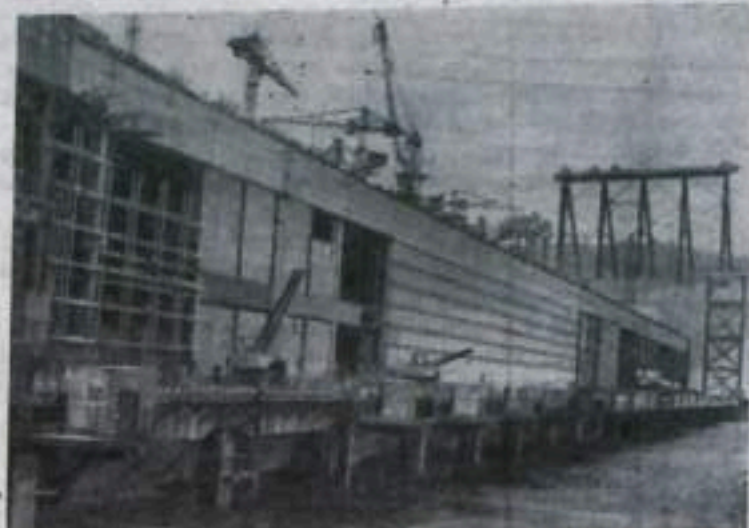
Красноярский край. Десять агрегатов Красноярской ГЭС начали вводить в эксплуатацию к 100-летию со дня рождения В. И. Ленина строители гиганта гидроэнергетики на Енисее. Шесть агрегатов уже дают энергию предприятиям и стройкам Сибири.
