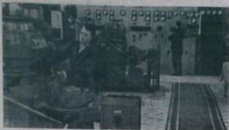
БЕЛОРУССКАЯ ССР. В деревне Гезалы вступила в строй новая Гезальская межколхозная гидроэлектростанция мощностью 350 киловатт, сооруженная на реке Молчадь силами 11 колхозов Дятловского района. Межколхозная ГЭС уже дала ток на колхозные фермы и в мастерские, в дома колхозников. На снимке: в машинном зале Гезальской межколхозной ГЭС. Фото А. Перегуды.
