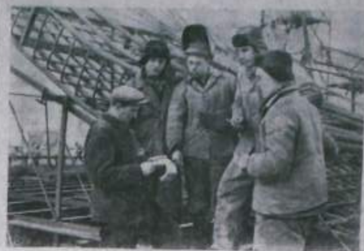
ПЕРМСКАЯ ОБЛАСТЬ. На строительстве Воткинской ГЭС ряд бригад работает в условиях зимней коллективной выжаривательной бригады. В их числе — бригада монтажников участка, возглавляемая Алексеем Васильевичем Фоминим. Все ее работники владеют несколькими специальностями, каждый может быть электросварщиком, бетонщиком, арматурщиком. НА СНИМКЕ (слева направо): Алексей Васильевич Фомин и рабочие его бригады Юрий Иванович Варилан, Борис Сергеевич Мельяков, Николай Григорьевич Погариничин и Николай Васильевич Погарин. Фото П. Абрамовича. Фотография ТАСС.
