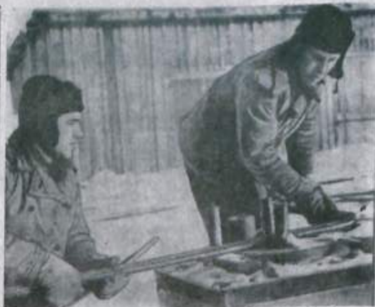
Бригаду арматурщиков, которой руководит Г. Коккин, знают многие строители Игушевского водохранилища. Она борется за звание бригады коммунистического труда, по почину луганцев решила выполнять смелые задания за 6 часов.
