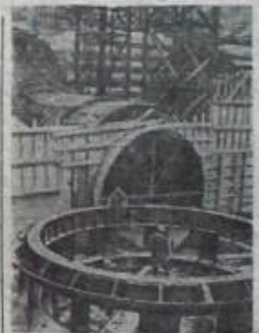
ИРКУТСКАЯ ОБЛАСТЬ. Строители Братской ГЭС установили в проектное положение статор первого гидроагрегата.
