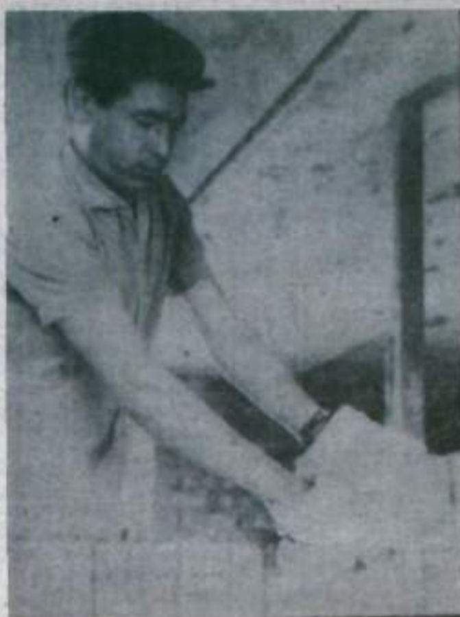
Бригада А. Н. Скачкова — одна из передовых в СМУ колхоза «Башкирское». Она добивается высокой выработки и хорошего качества, на строительстве многоквартирного жилого дома сэкономила 3000 рублей.
