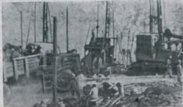
В Объединенной Арабской Республике успешно идет сооружение высотной Асуанской плотины. Советский Союз предоставляет дружественной стране, борющейся за ликвидацию тяжелых экономических последствий колониализма, большое количество необходимой строительной техники. Здесь работают многие советские специалисты.
