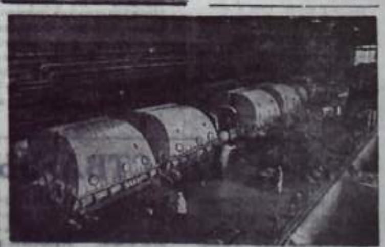
Ленинградская атомная электростанция имени В. И. Ленина, построенная с уран-графитовыми реакторами, охлаждаемыми кипящей водой.—крупнейшая в Советском Союзе. Ее главный корпус состоит из двух энергетических блоков с общим машинным залом в раздельных помещениях для реакторов.
