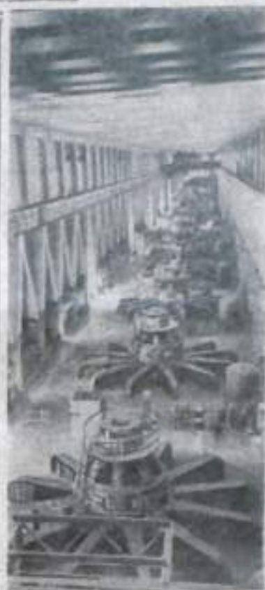
Братская ГЭС. Машинный зал.
