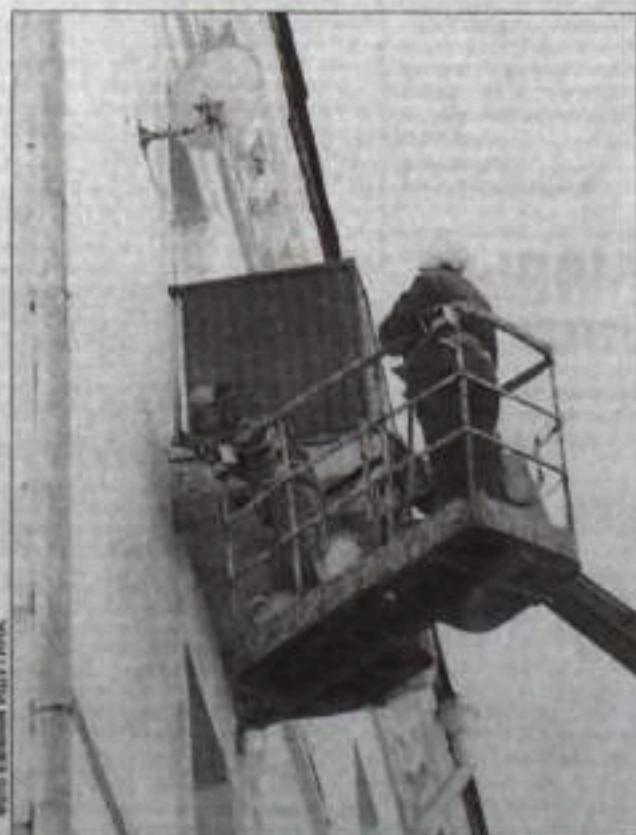
Работники РЭУ-7 занимаются косметическим ремонтом балконов. Автогидроподъемниками их обеспечивает МУП «Транспортная база».
