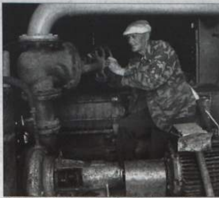
Машинист насосной станции Ахмет Кутляхметов открывает задвижку для подачи воды.
