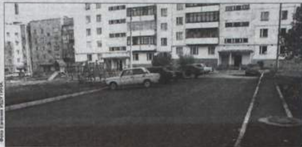
В рамках Республиканской целевой программы в городе ведутся работы по ремонту и благоустройству восьми придомовых территорий с охватом 20 домов. Двор дома №27 по улице Энергетиков попал в список счастливых. В настоящее время там силами МАУ ДОР проведены работы по расширению проезжей части и укладке свежего асфальта, устанавливаются новые бордюры, расширяется площадь автостоянки, прокладываются новые тротуары.
